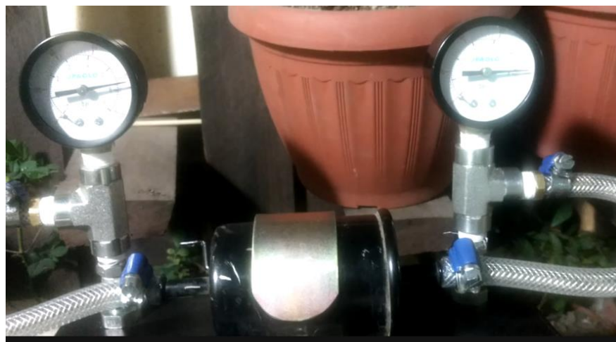
Figura 18. Medición de presión a filtro con 30 mil km
