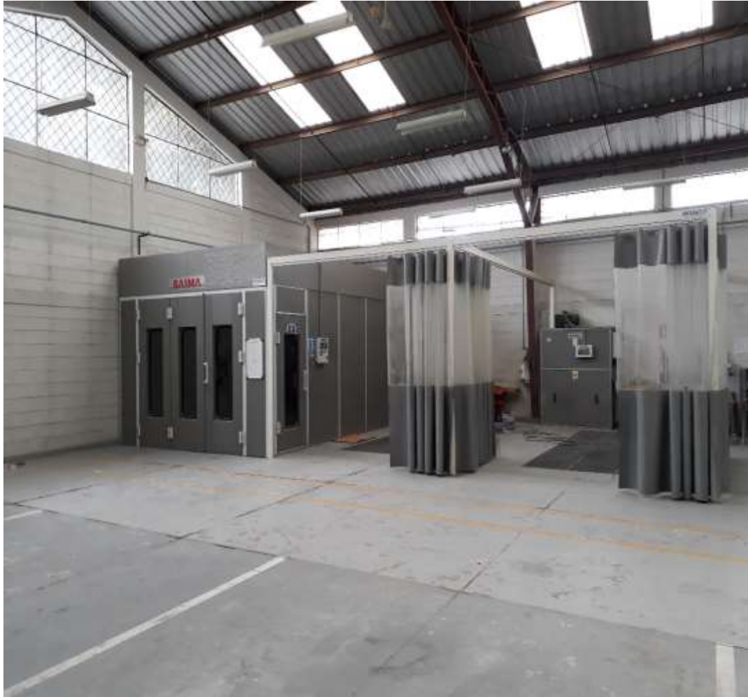
Figura 6. Cabina y zona de preparación de pintura.
