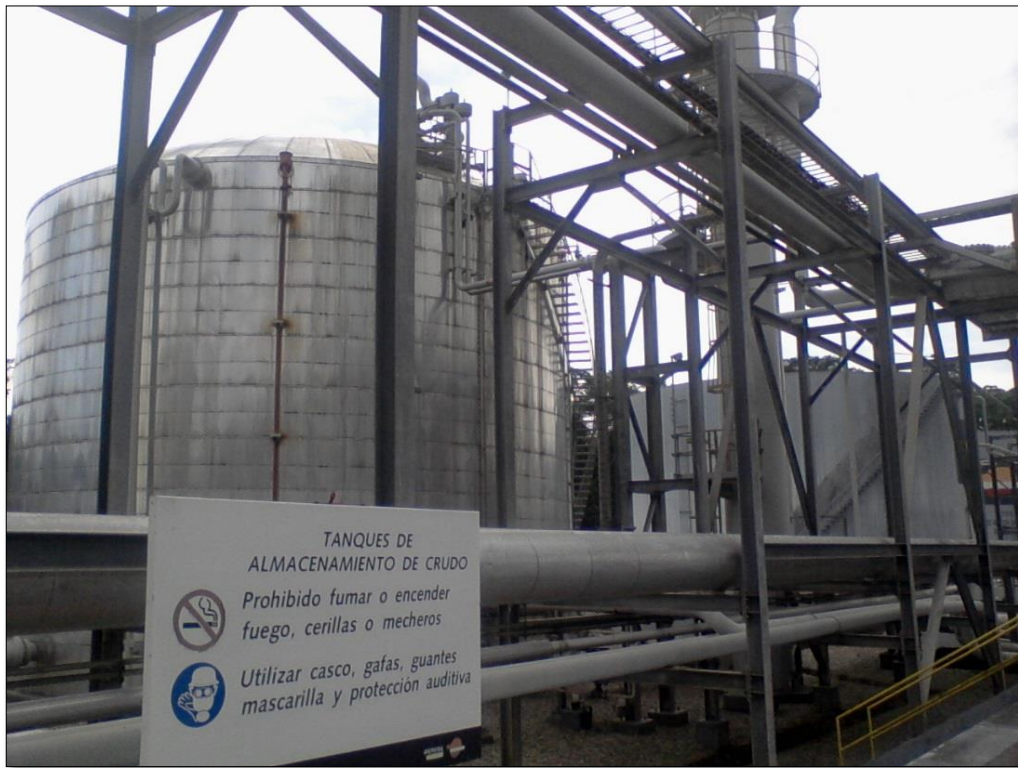
Figura 16. Tanque de almacenamiento de crudo para generación
