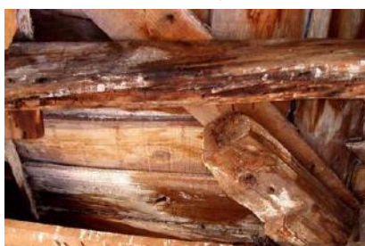
FIGURA 54 Viga de madera podrida. FUENTE: biología.com.ec
