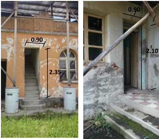
FIGURA 109 Las puertas de acceso no son lo suficientemente anchas para el ingreso de discapacitados. FUENTE: Anahí Barros
