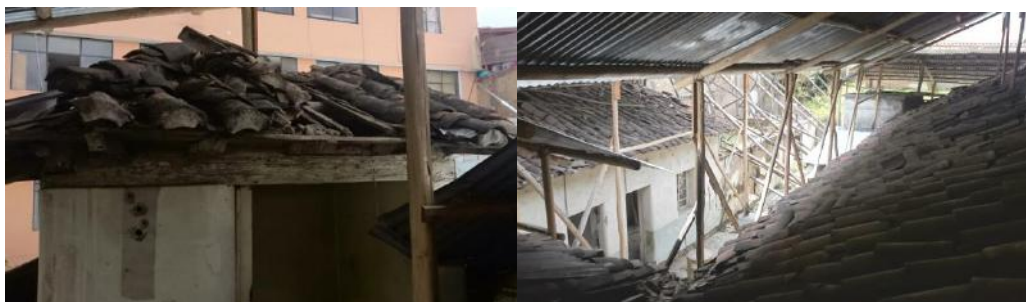
FIGURA 36 Deterioro, daños y defectos de las cubiertas en la “Casa Sincholagua” FUENTE: Anahí Barros
