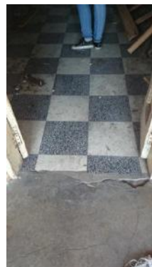
FIGURA 119 Piso de corredor incompleto. FUENTE: Anahí Barros
