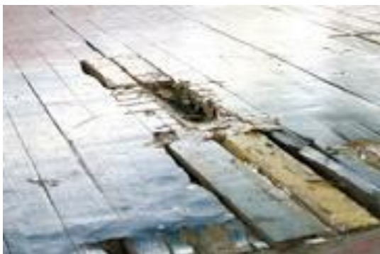
FIGURA 120 Piso de dormitorio arqueado y levantado por la humedad. FUENTE: Anahí Barros
