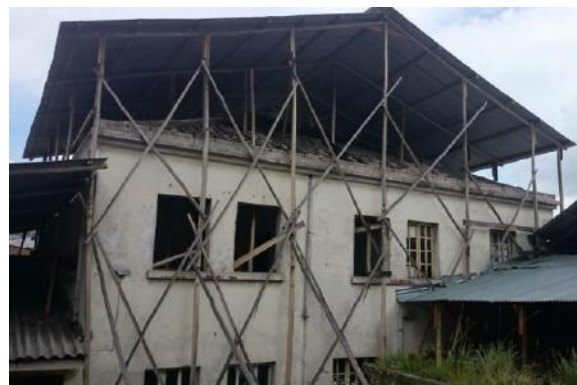
FIGURA 123 Cubierta provisional de lamina de zinc, retenida por pingos (apuntalamiento). Paredes con humedad y agrietadas.
