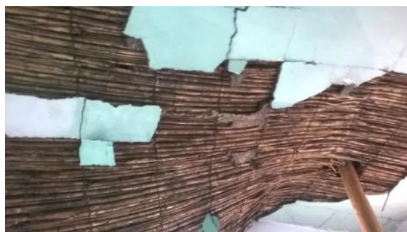
FIGURA 52 Deterioro del cielorraso de Carrizo en la "Casa Sincholagua". FUENTE: Anahí Barros
