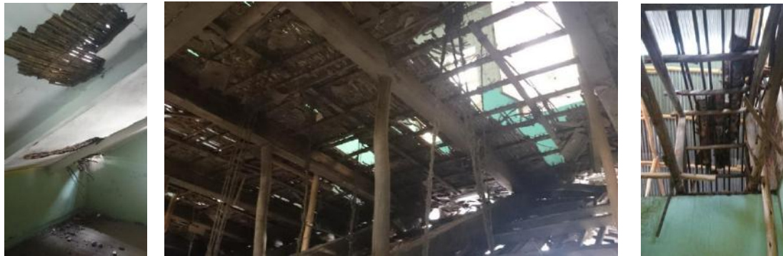
FIGURA 117 Cielo Raso de carrizo en deterioro, afectados por la humedad, vigas de soporte astilladas retenido temporalmente con pingos que sostienen directamente la cubierta. FUENTE: Anahí Barros
