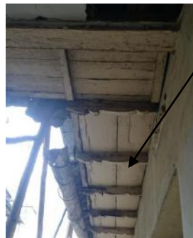
FIGURA 114 Canes de madera reteniendo aleros de madera, apolillados. FUENTE: Anahí Barros
