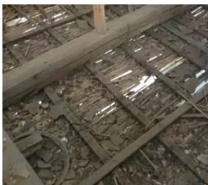
FIGURA 35 Carrizos en estado de deterioro en entrepisos de la "Casa Sincholagua" FUENTE: Anahí Barros
