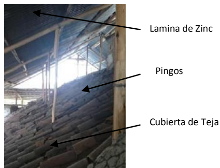
FIGURA 122 Cubierta de teja incompleta y levantada.
