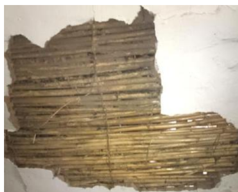
FIGURA 34 Carrizos en estado de deterioro en entrepisos de la "Casa Sincholagua" FUENTE: Anahí Barros
