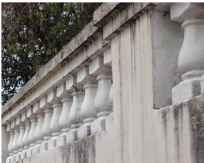
FIGURE 116 Balaustradas de cemento Con humedad y descoloridos. FUENTE: Anahí Barros
