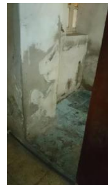
FIGURA 118 piso de baño desgastado por alto tránsito. FUENTE: Anahí Barros
