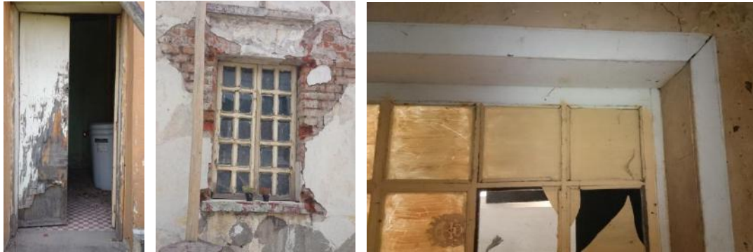
FIGURA 121 Puerta astillada, con humedad y descolorida; marco de ventana astillado, y descolorido; y Vidrios de ventanas rotos.
