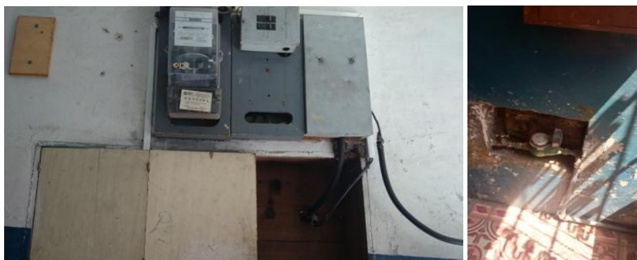
Imagen 14. Medidores de luz eléctrica y agua potable.
