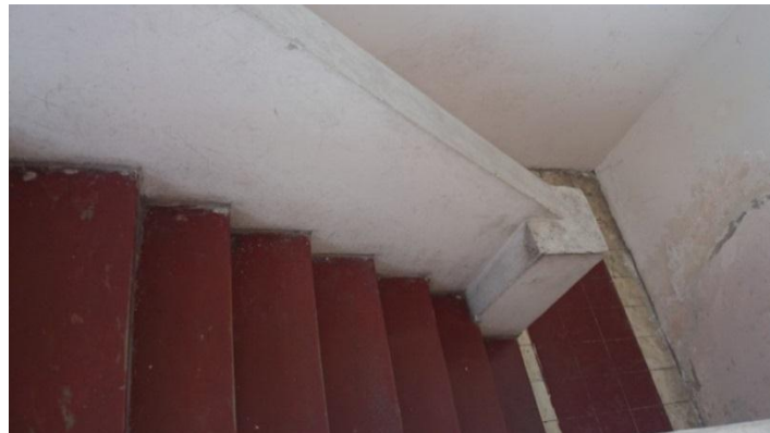
Imagen 26. Alteración tipológica Casa Galápagos. Cajón de escaleras
