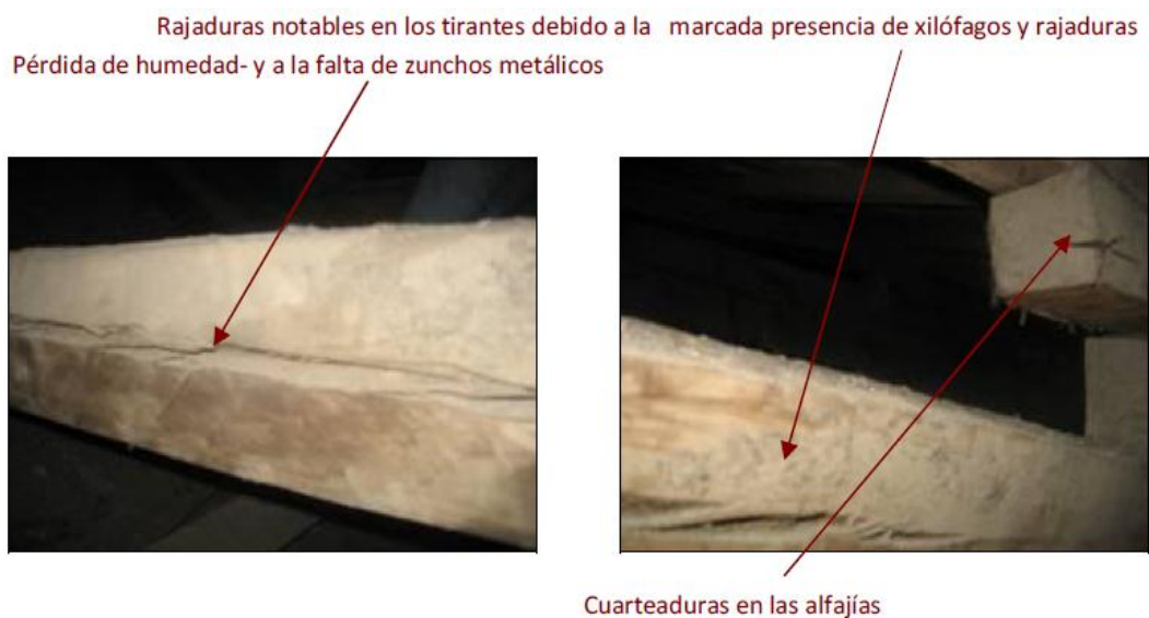
Gráfico 17. Cubierta de madera con cuarteaduras y colonias de hongos
