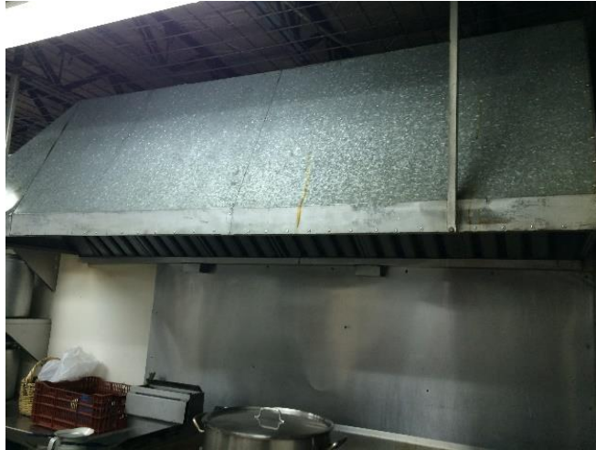
Ilustración 5.- Campana y extractor de olores
