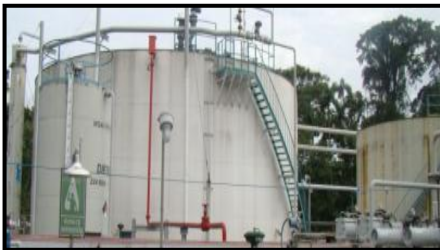
Figura 10. Tanques de almacenamiento del campo Villano Alfa
