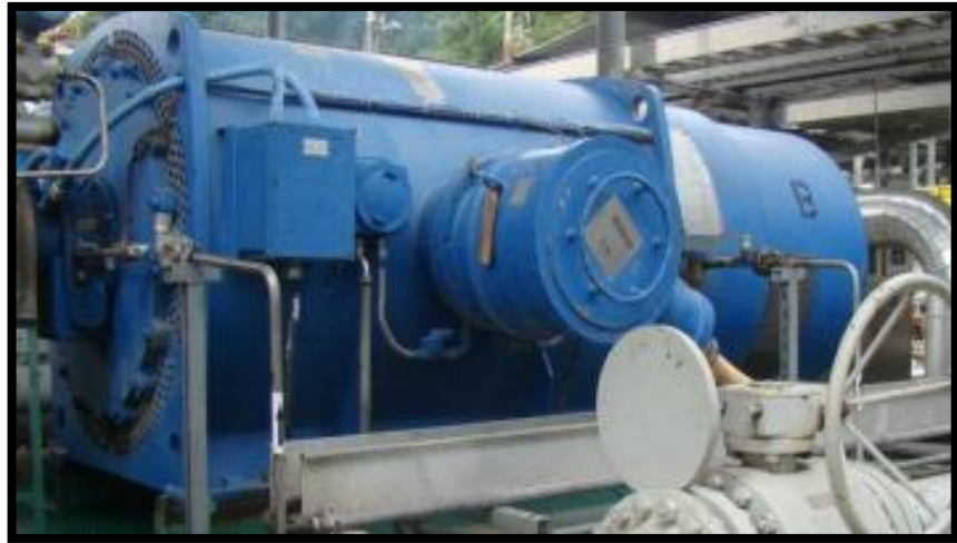
Figura 13. Bombas para inyección de agua WIP (AGIP OIL)
