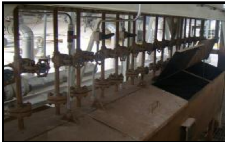
Figura 16. Sistema de inyección de químicos
