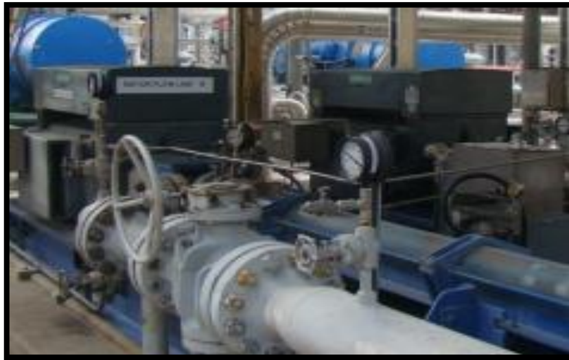
Figura 12. Bombas de línea de flujo
