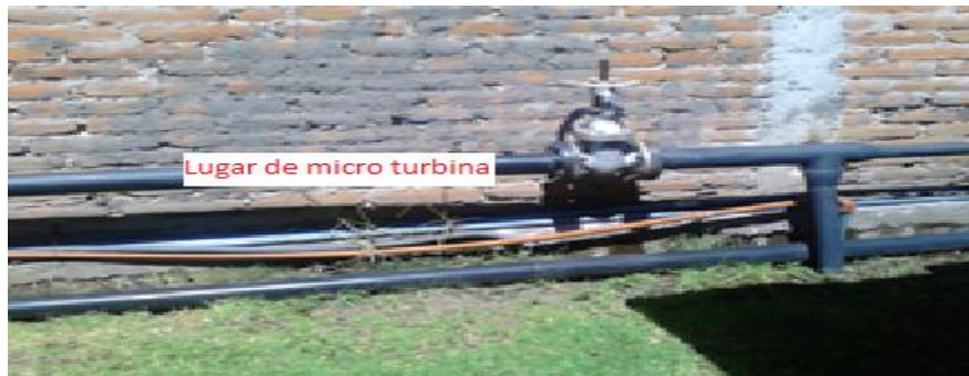
Figura 34. Lugar de la micro turbina hidráulica.
