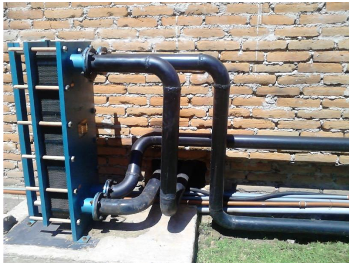
Figura 26. Ingreso del agua al radiador.
