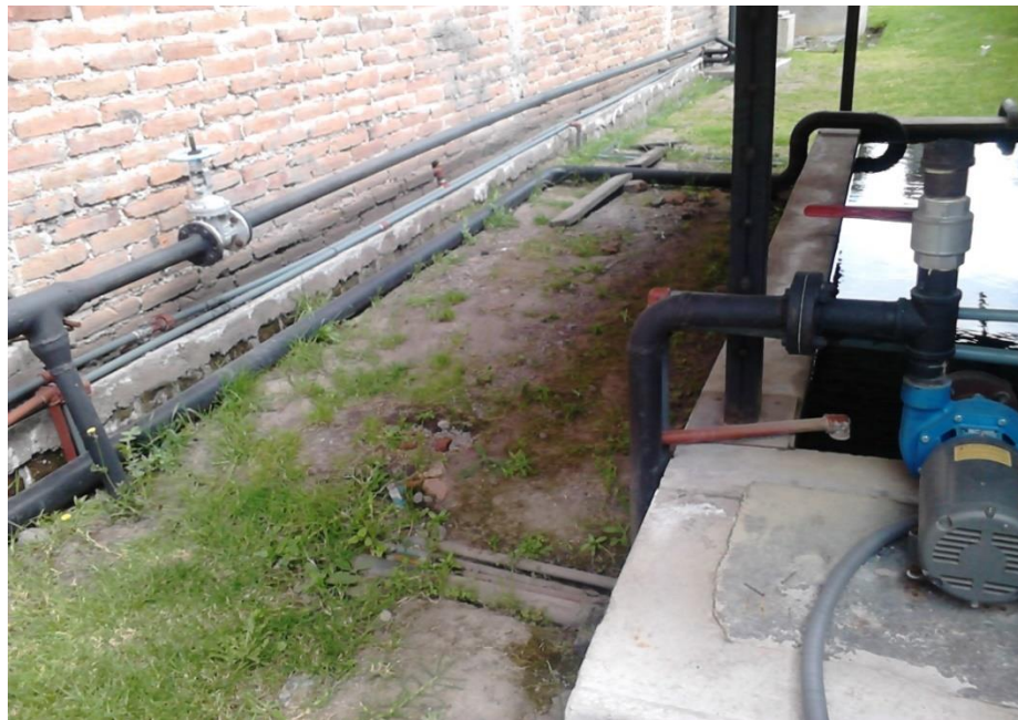
Figura 24. Tubería de 2 \frac{1}{2} pulgadas.
