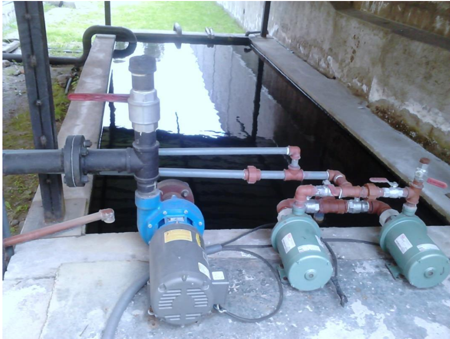
Figura 23. Bomba centrífuga en TOPESA S.A
