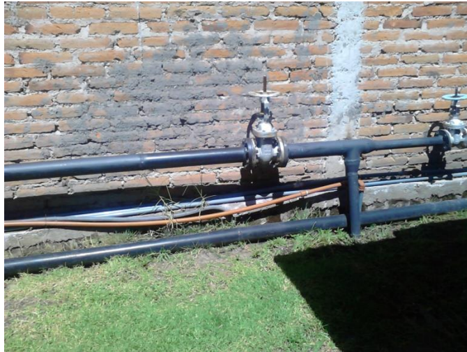
Figura 25. Tubería de 4 pulgadas.
