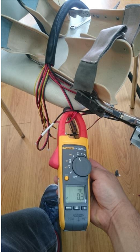
Figura 61. Medición de corriente en los actuadores
