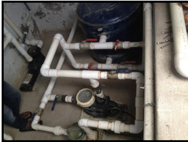
Fig. 2.28 Cuarto de bombas
