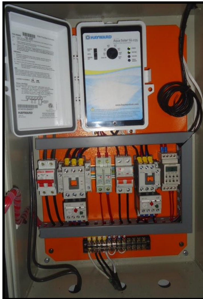
Figura 4.13 Tablero de Control
