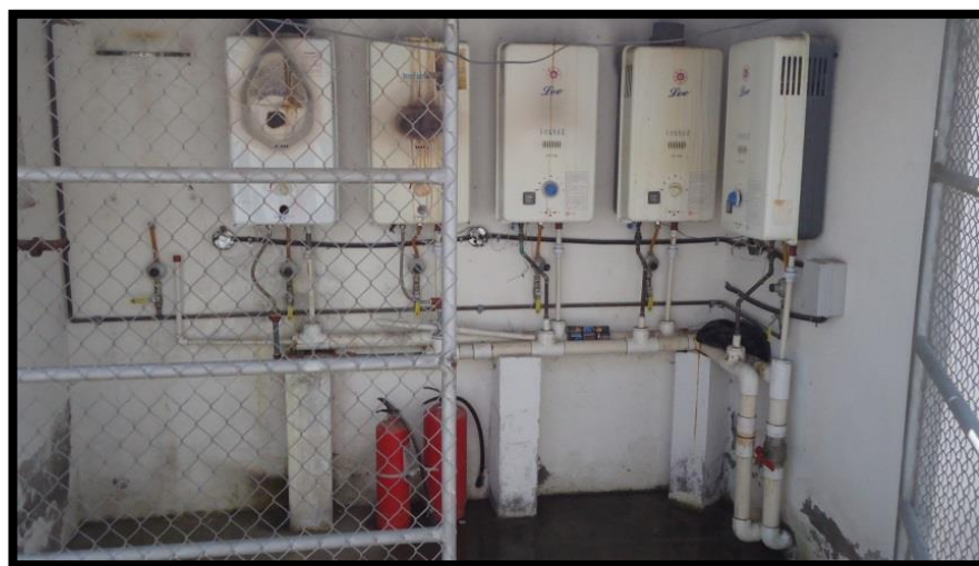
Fig. 2.29 Calefones en funcionamiento
