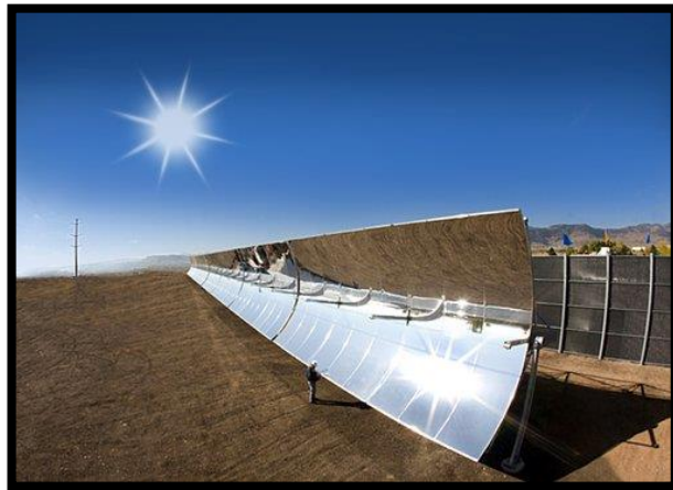
Fig. 2.21 Concentradores Cilindro-Parabólicos (San José, 2009)
