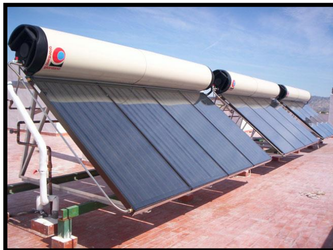
Fig. 2.8 Sistema de Captación de Energía Solar Térmica (ACS) (San José, 2009)
