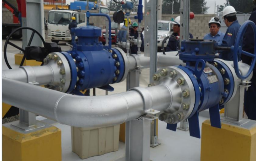
Cámara de Lanzamiento
