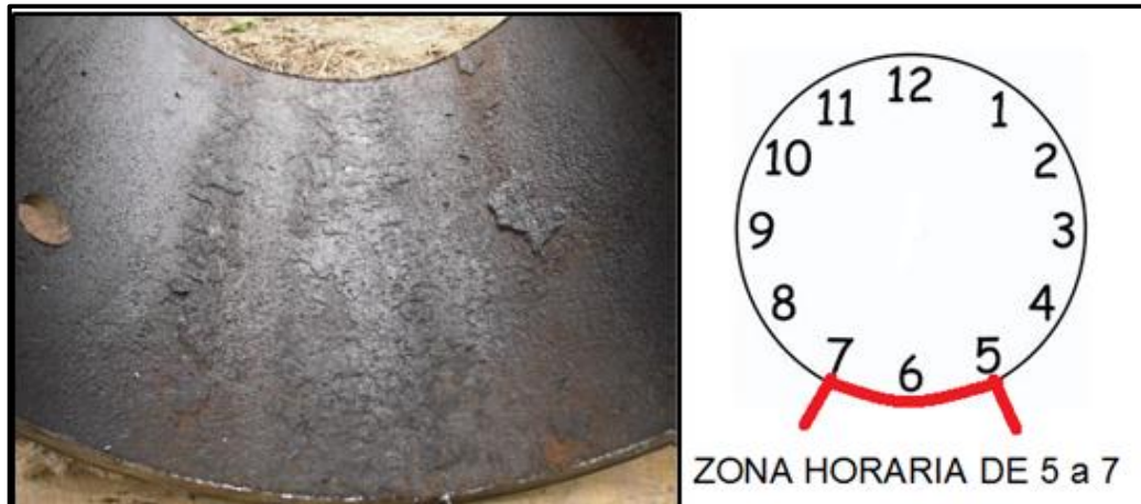
Figura 44. Vista interna corte PK 147+749,331 - 6 hs. luego del corte – posición horaria 5 a 7
