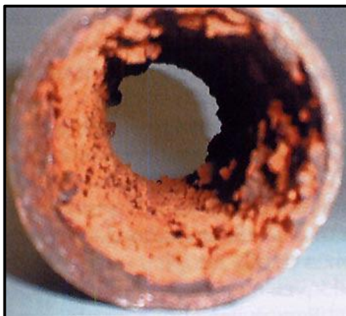
Figura 1. Tubería afectada por la Corrosión
