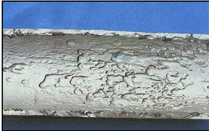
Figura 5. Corrosión por CO 2
