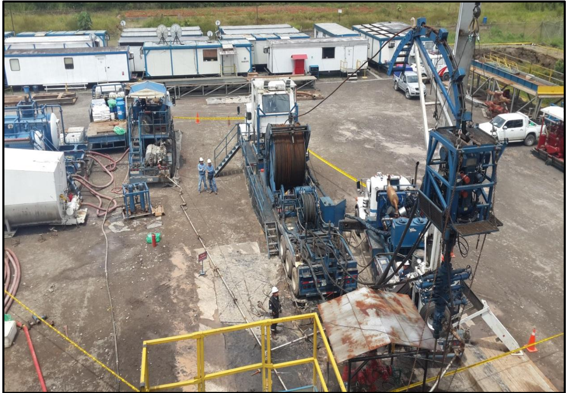
Figura 66. Rig up de la Unidad de Coiled Tubing
