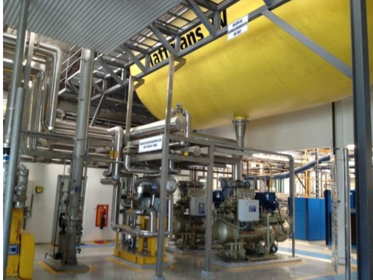
Figura 33. Sistema de Vapor de la Planta Cervecera (Cervecería Nacional, 2014)
