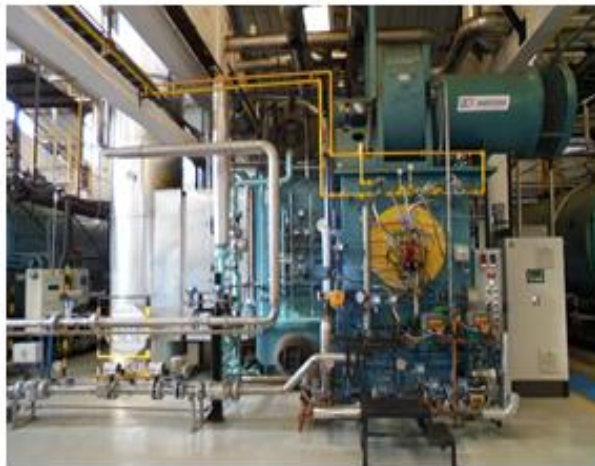
Figura 32. Sistema de Vapor de la Planta Cervecera (Cervecería Nacional, 2014)
