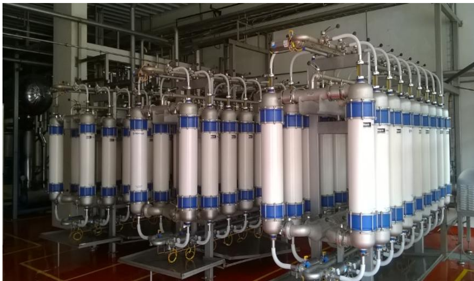
Figura 28. Filtros BMF de la Planta Cervecera (Cervecería Nacional, 2014)
