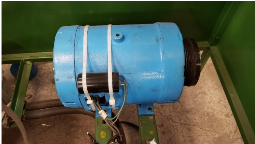
Figura. 33 Montaje motor eléctrico
