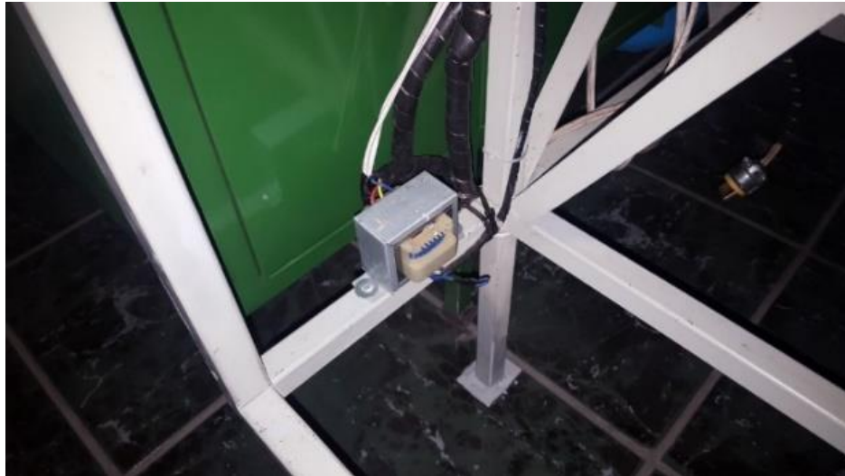
Figura 43. Convertidor de voltaje.
