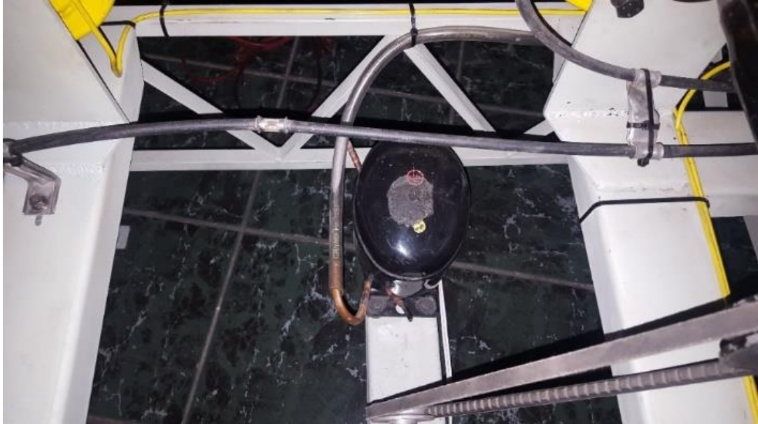
Figura 45. Bomba de vacío
