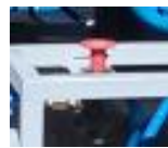
Figura 65. Válvula del bloqueo del sistema
