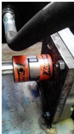
Figura 50. Base de la bomba hidráulica
