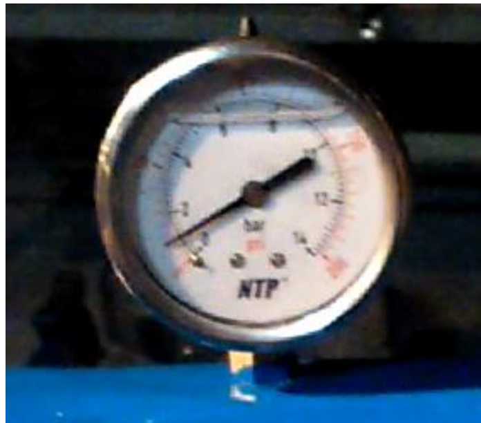
Figura 43. Ubicación de manómetro en el panel de control.
