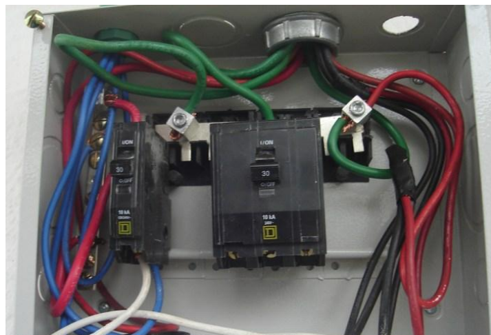
FIGURA 46. CAJA DE BREAKES
