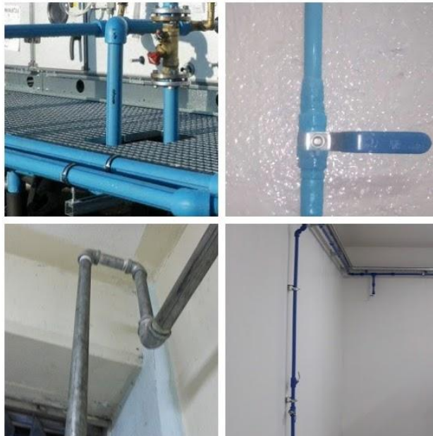
FIGURA 35. INSTALACIONES DE AIRE COMPRIMIDO
