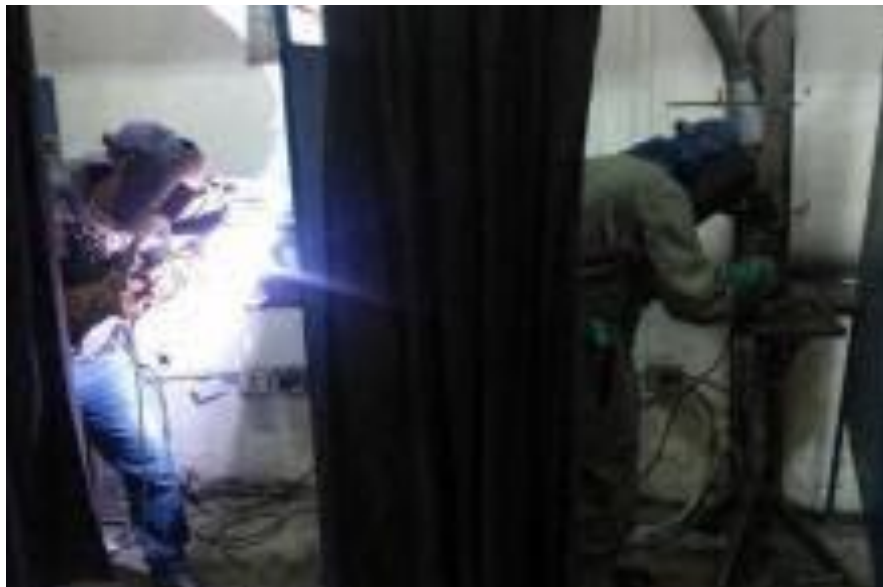
Figura 44. Iluminación del área de suelda
