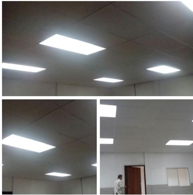
FIGURA 43. INSTALACIONES DE LUZ DEL ÁREA DE TRATAMIENTOS TÉRMICOS
