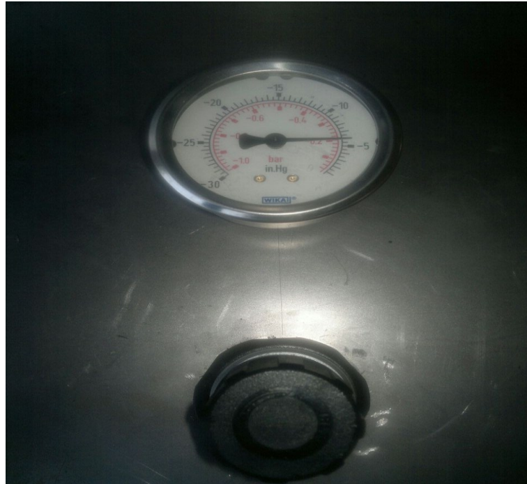
Figura 81. Manómetro de vacío y regulador de presión
