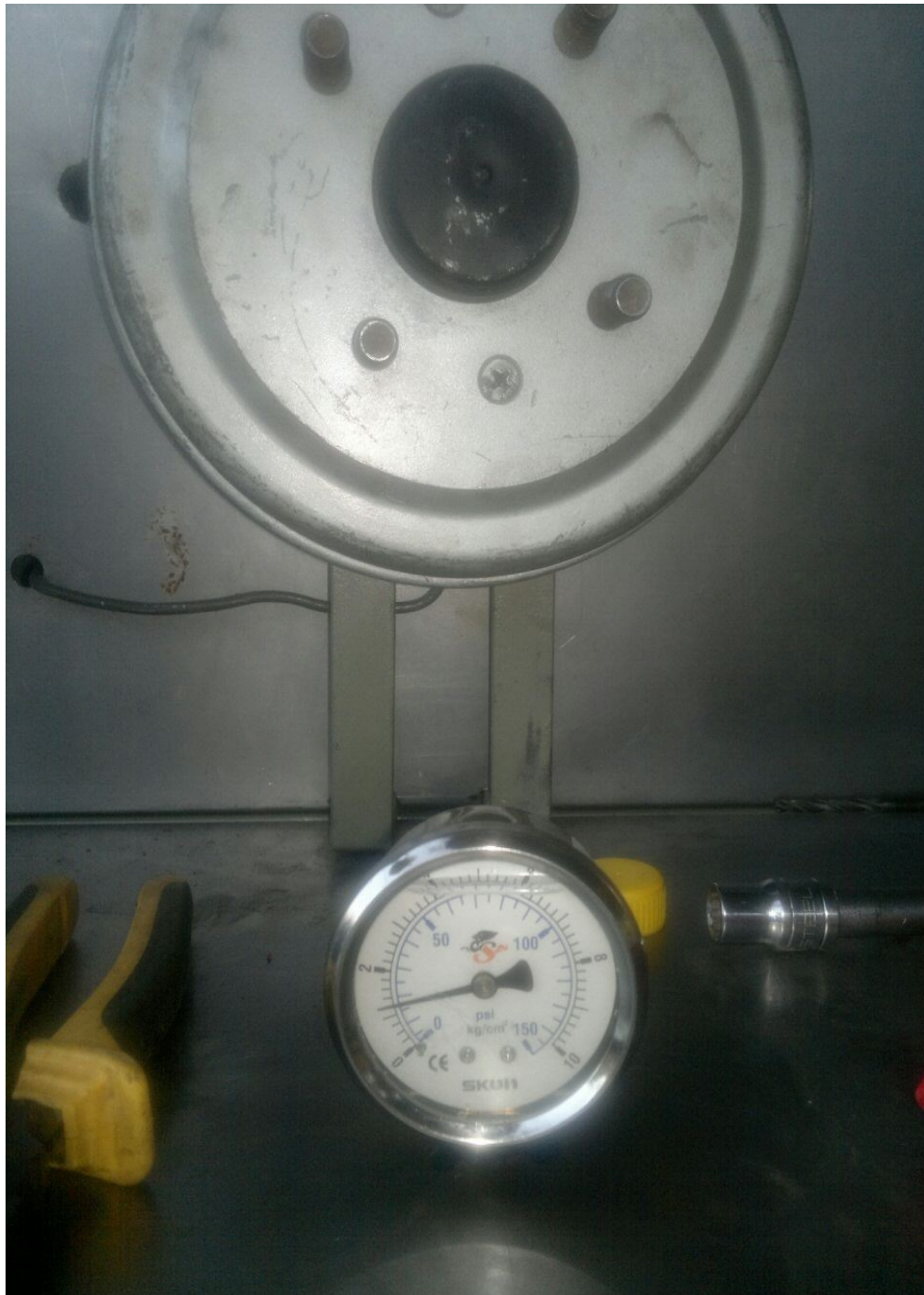
Figura 80. Manómetro de presión de la entrada de aire
