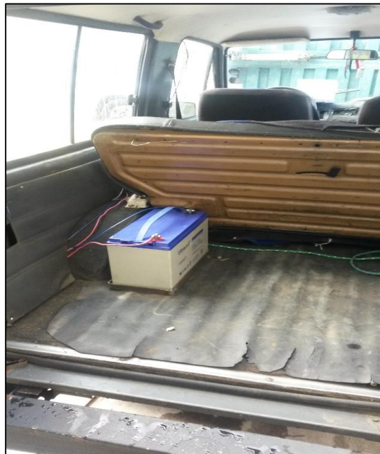
Figura 61. Batería del sistema instalada en la parte posterior y cableado de instalación
