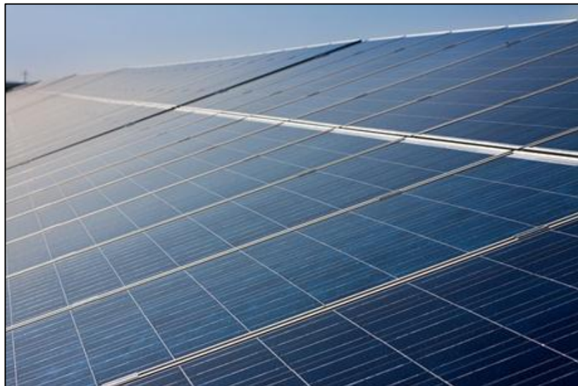
Figura 5. Paneles Solares Fotovoltaicos Policristalinos (Energías Renovables, 2014)
