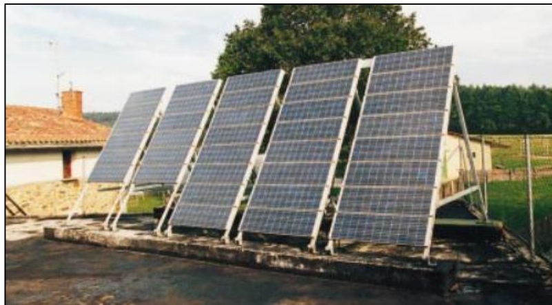
Figura 7. Paneles Solares en instalación fotovoltaica.
