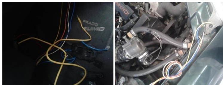
Figura 85. Cableado interior y exterior.
