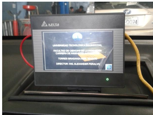
Figura 89. Pantalla táctil instalada.
