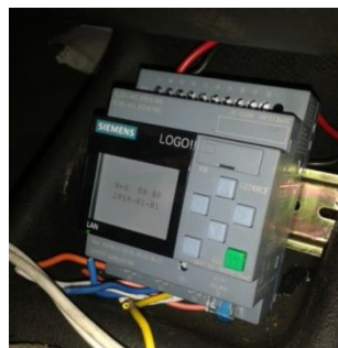
Figura 88. Micro controlador instalado.
