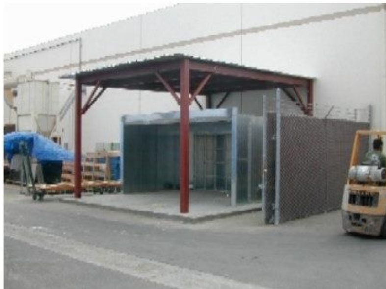
Figura 12. Cabina de pintura electrostática (Suratep S.A., 2004)
