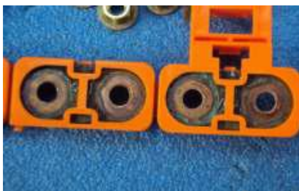
Figura 34. Conectores en mal estado.
