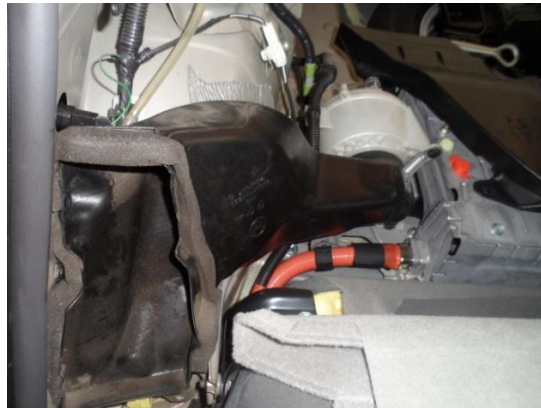
Figura 40. Compartición para el enfriamiento de la batería híbrida.
