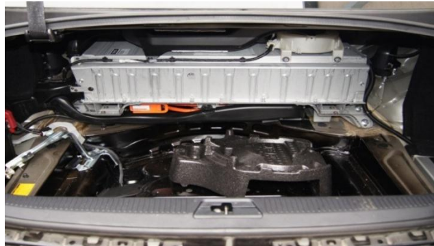
Figura 8. Ubicación de la batería.
