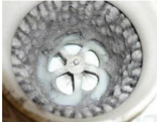
Figura 41. Obstrucción del soplador de refrigeración de la batería HV.
