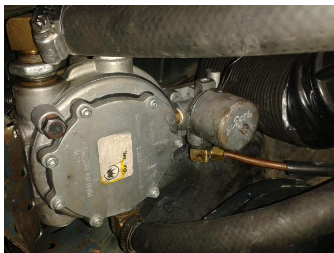
Figura 40. Evaporador / Regulador con electroválvula.
