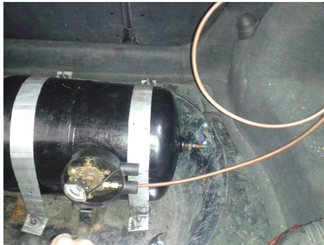
Figura 39. Tanque estacionario GNV / Tubería de cobre
