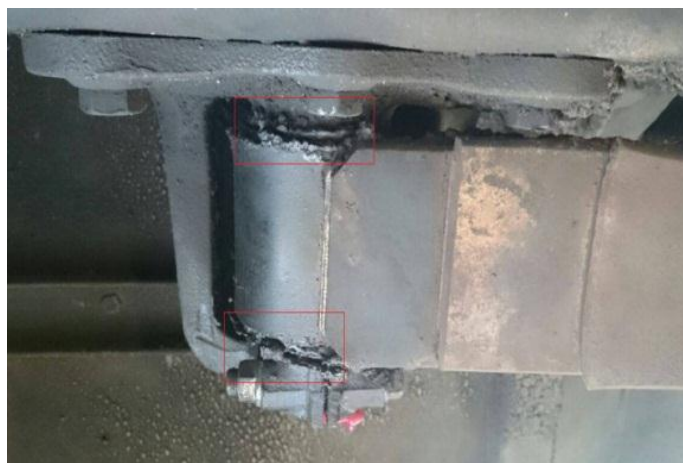
Figura 17. Defecto tipo 3 en bujes de ojo de ballestas (excesiva holgura)
