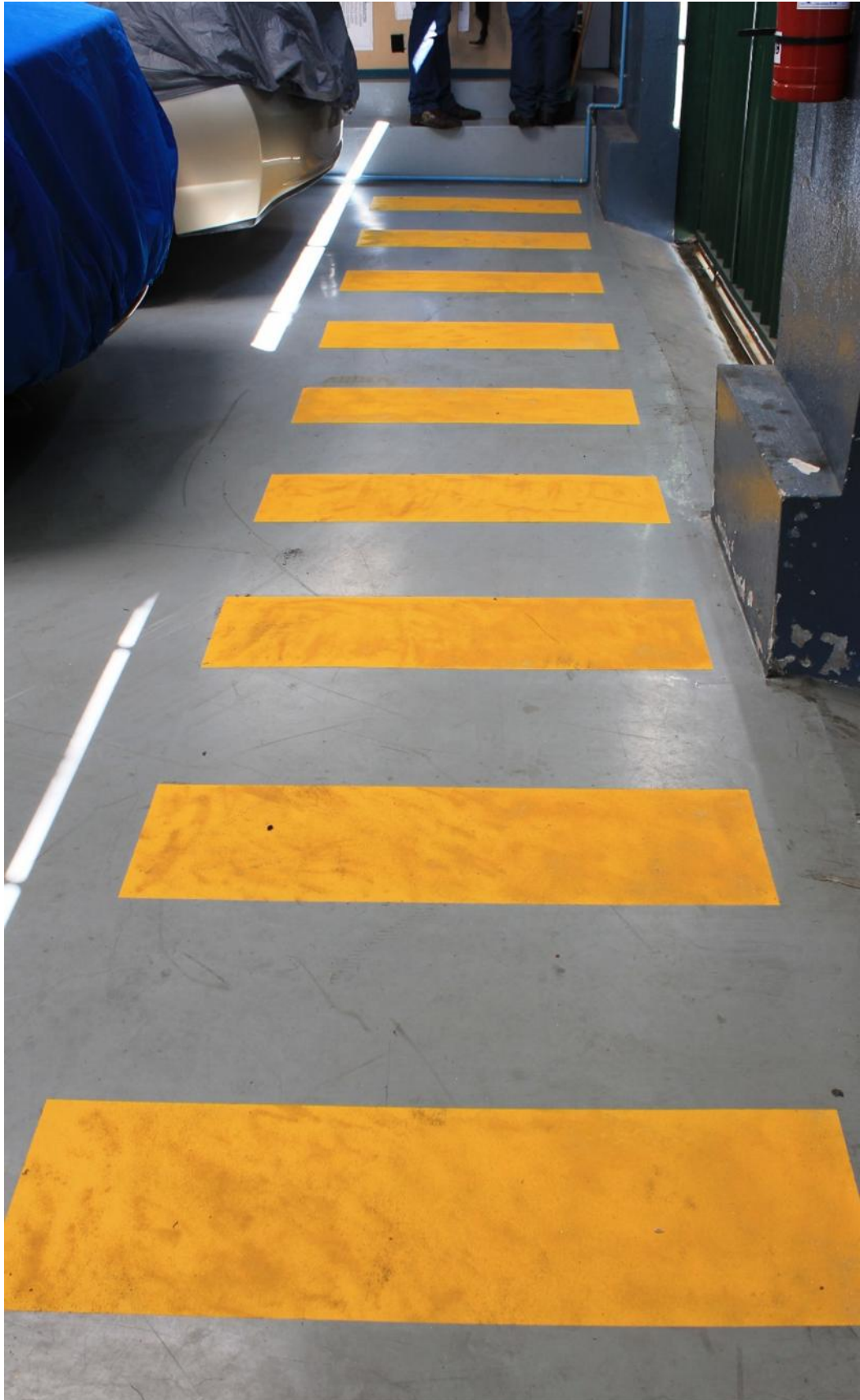
Figura 62. Pintado de zona de seguridad
