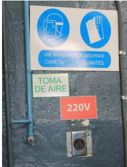
Figura 57. Instalación de señales en taller de Ing. Automotriz
