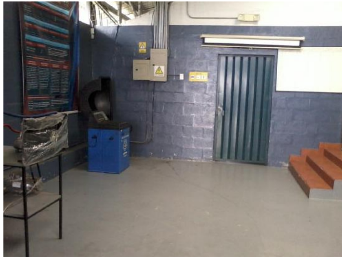
Figura 45. Identificación de riesgos eléctricos mal rotulados
