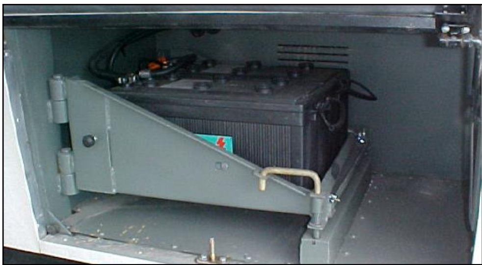
Figura 35. Bodega de baterías
