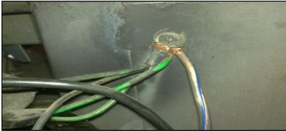
Figura 45. Conexión a tierra inadecuada (Taller Eléctrico Chávez, 2014)
