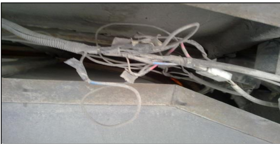
Figura 44. Desorden en conexiones (Taller Eléctrico Chávez, 2014)
