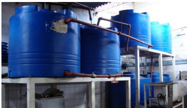
Figura 7. Fotografía de PTAR disfuncional
