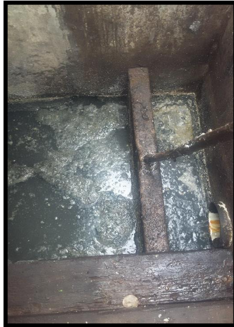
Figura 12: Trampa de Grasas cámara 1 y 2.
