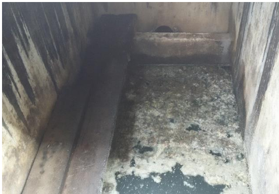
f. Grasas flotantes en segunda cámara de la trampa
