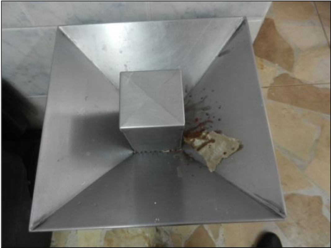
Figura 31. Manejo inadecuado de trampas de aceites y grasas
