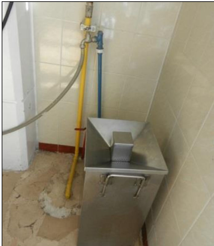
Figura 32. Ubicación inadecuada de trampas de aceites y grasas
