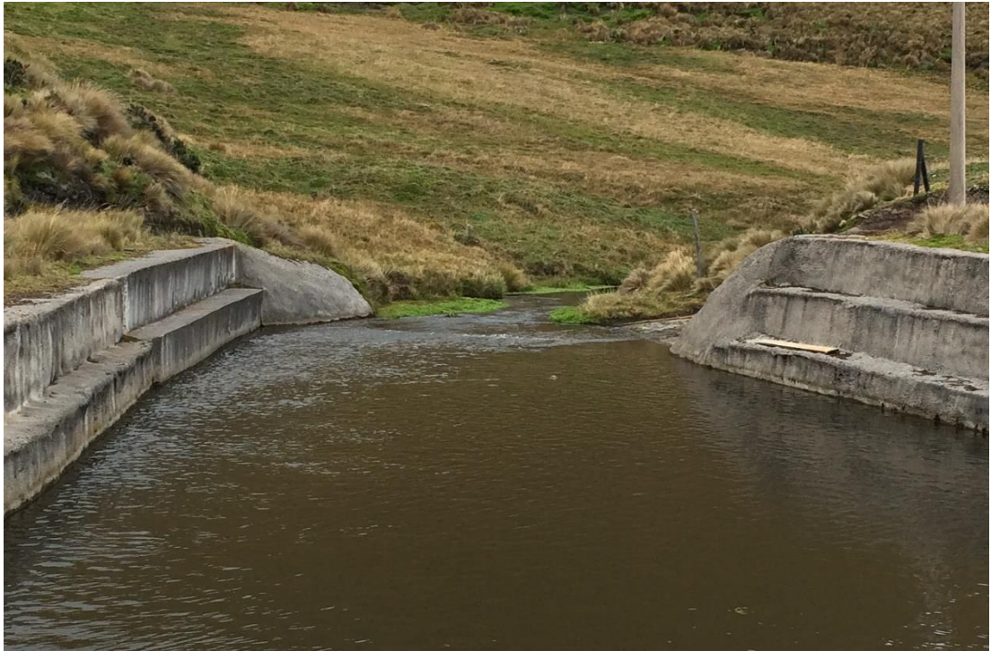
Figura 8. Captación de agua del río Jatunhuaycu, Sistema la Mica _ Quito Sur.
