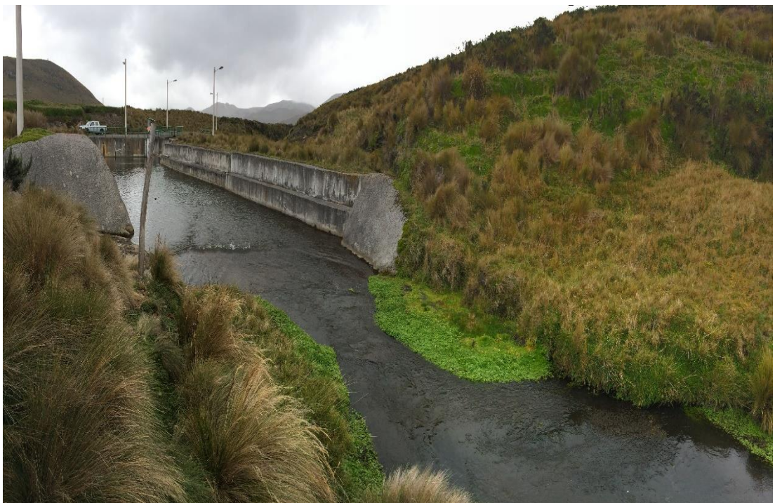
Figura 9. Captación de agua del río Jatunhuaycu, Sistema la Mica _ Quito Sur.
