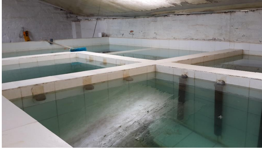
Figura 15. Planta potabilizadora de agua
