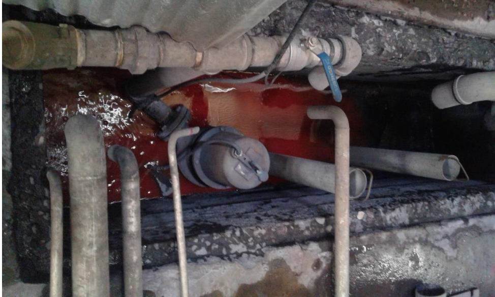
DESAGUE MAQUINA 1 Y 2 TINTURADO
