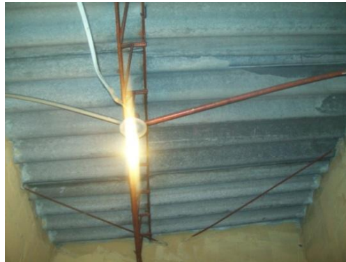
3.2 Techo, instalaciones eléctricas
